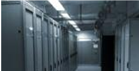
Abb.: Ein funktionierende Wärmeabfluss in Technik-, Netzwerk sowie Serverschränken muss rund um die Uhr gewährleistet sein. Eine Beeinträchtigung oder gar ein Ausbleiben der Schrankkühlung kann für hitzeempfindliche Systeme fatale Folgen haben. Der Infrastruktur Monitoring Anbieter Didactum bietet ein umfangreiches Sensorik-Sortiment für die 24/7 Schranküberwachung.
